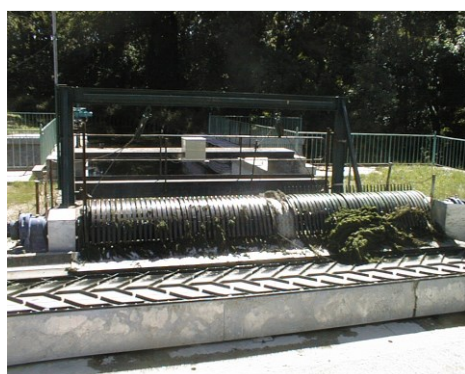
Dégrilleurs au pont-canal de la Curraize
