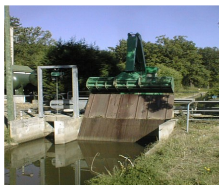
Dégrilleur du Mont d'Uzore
