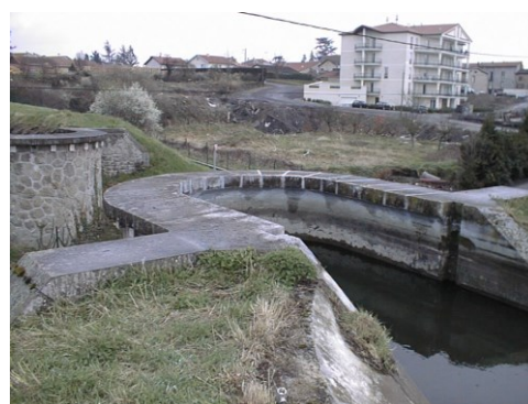
Siphon de l'Impasse du Canal
