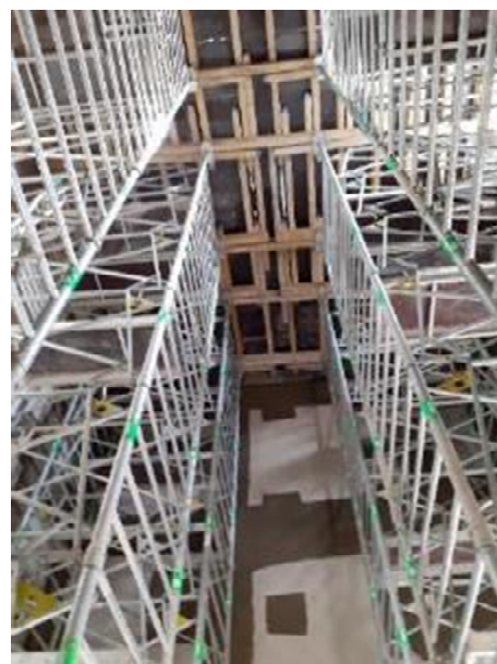
Bâche de connexion retenue station
